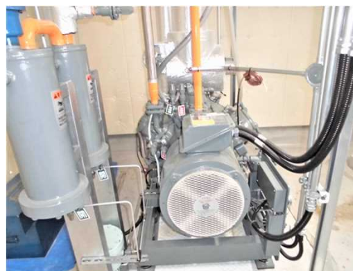
レシプロ式冷凍機 (冷凍設備機械室)
